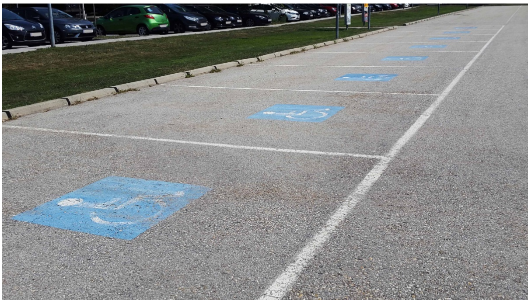
Abbildung 15: Behindertenparkplätze Fachhochschule St. Pölten und Campus & City Radio 94.4
